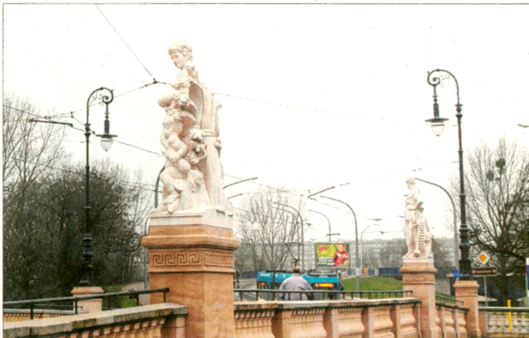
Blick auf zwei der vier Kandelaber, die nach historischem Vorbild wieder die Zollbrücke schmücken. Die Brückensanierung ist damit abgeschlossen. Foto: Uli Lücke
